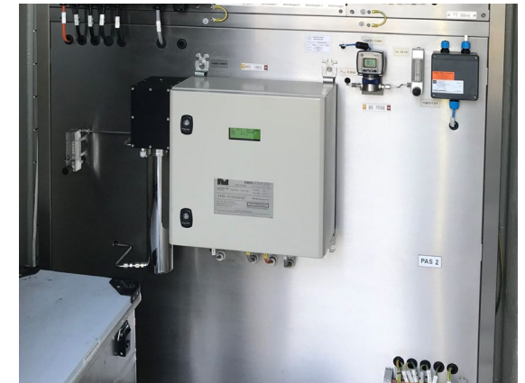
H 2 S-Messgerät LaserGasII von neo monitors Sauerstofftransmitter oxy.IQ von GE
